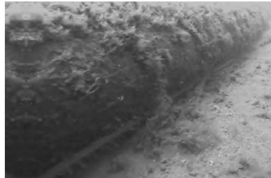
(d) Image 2 of corroded pipe
