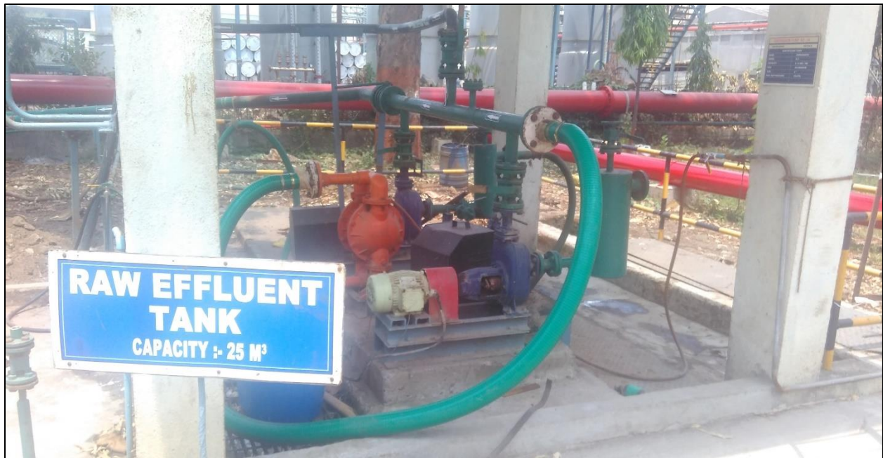
Fig. 2.2: Raw latex effluent collection tank
